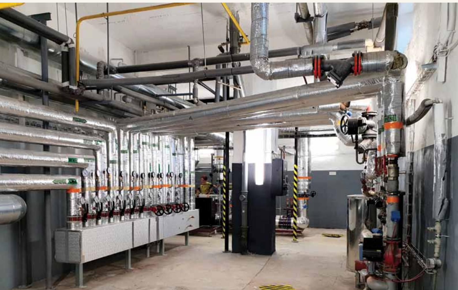
Prostor předávací stanice HTS
